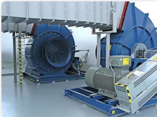
Le balourd est critique dans les installations a ventilateurs (transmission directe ou poulie courroie)
