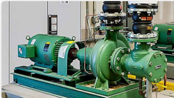
Le désalignement est critique dans les installations a machines accouplées (transmission directe)
